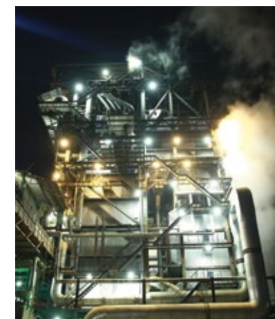
Hệ thống luyện đường tại nhà máy Biên Hòa - Ninh Hòa
