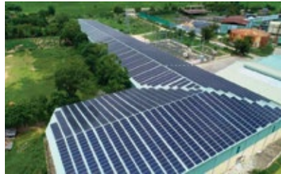
Điện mặt trời áp mái tại Tây Ninh
