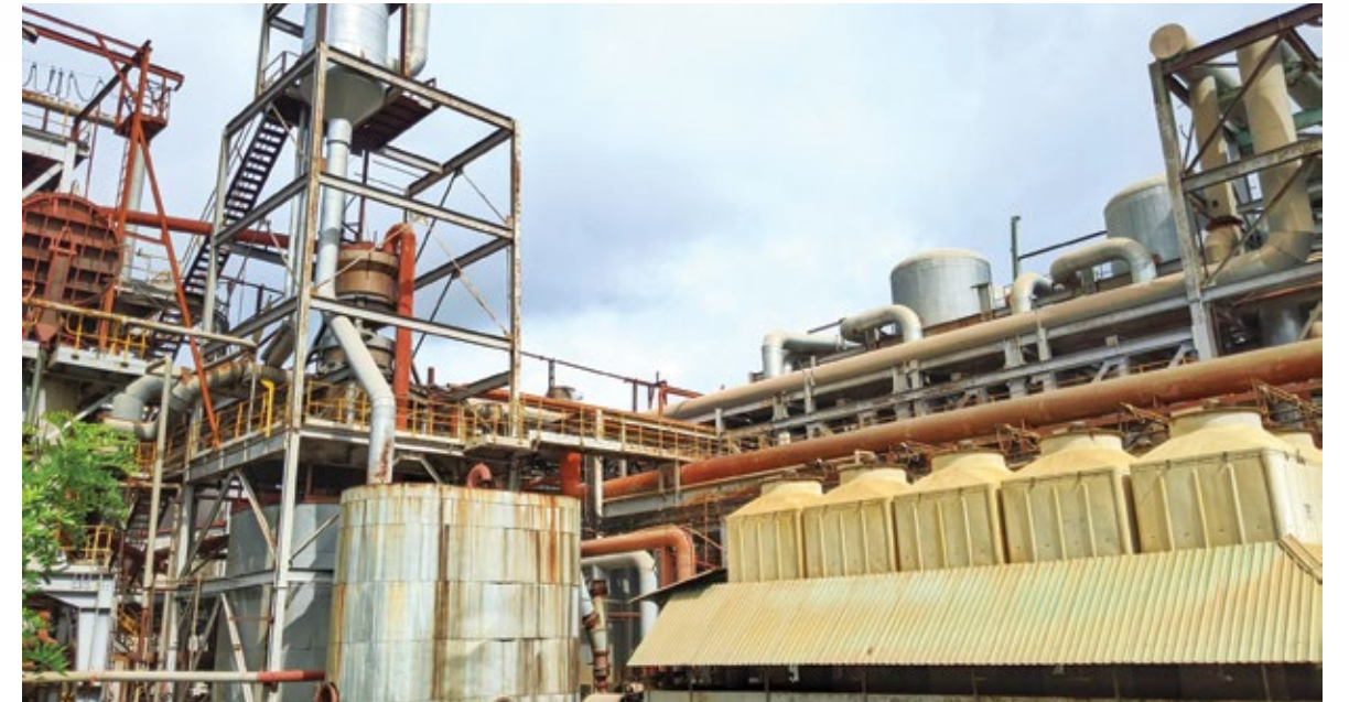
Hệ thống bốc hơi tại nhà máy Biên Hòa - Ninh Hòa
