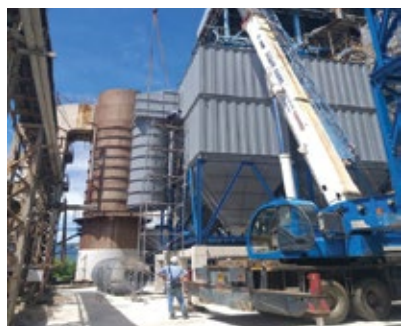
Lò hơi tại nhà máy Đường Biên Hòa - Ninh Hòa
