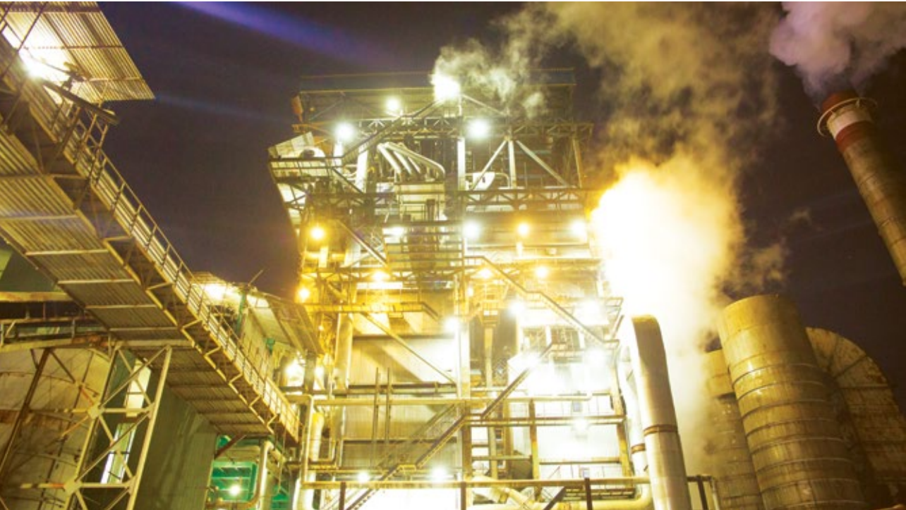
Hệ thống luyện đường bằng nhiên liệu Biomass tại nhà máy Biên Hòa - Ninh Hòa
